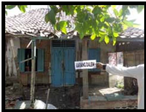
Rumah tidak layak huni di Kelurahan Karang Dalem Kabupaten Sampang
